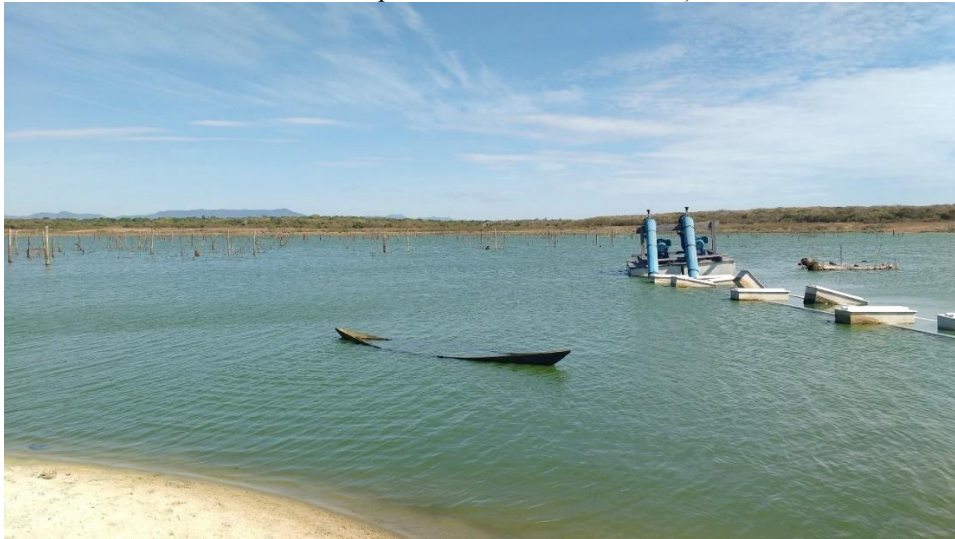
Figura 12 - Instalação para captação do volume morto – Barragem Catucinzenta (Conjunto motor-bomba flutuante instalado para acessar o volume morto)
